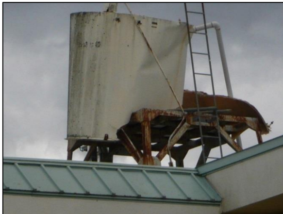
貯水槽 断裂損壊
