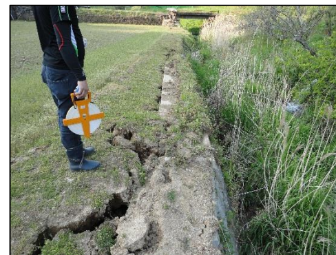
大野川(護岸亀裂)
