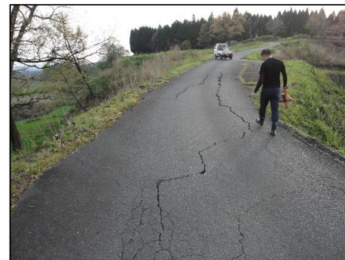
上寺・造別当線(路面亀裂)
