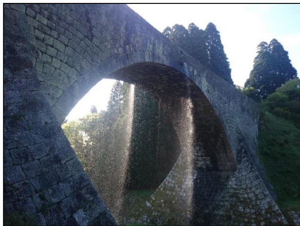
アーチ下部より全面的に漏水
