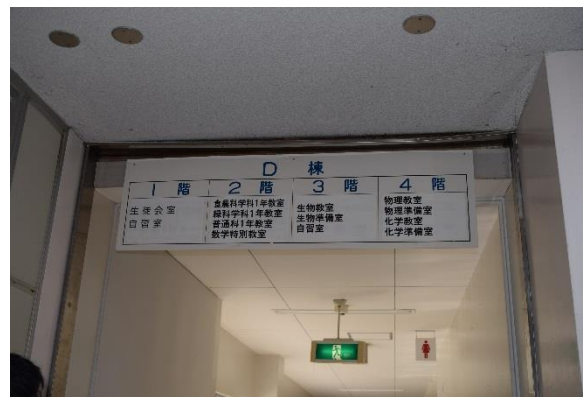
D棟-E棟接続部損傷(通行禁止)
