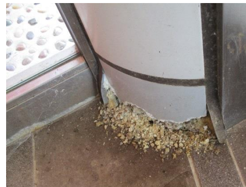
B館1階柱損傷
