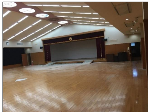
千寿苑多目的ホール 照明板落下
