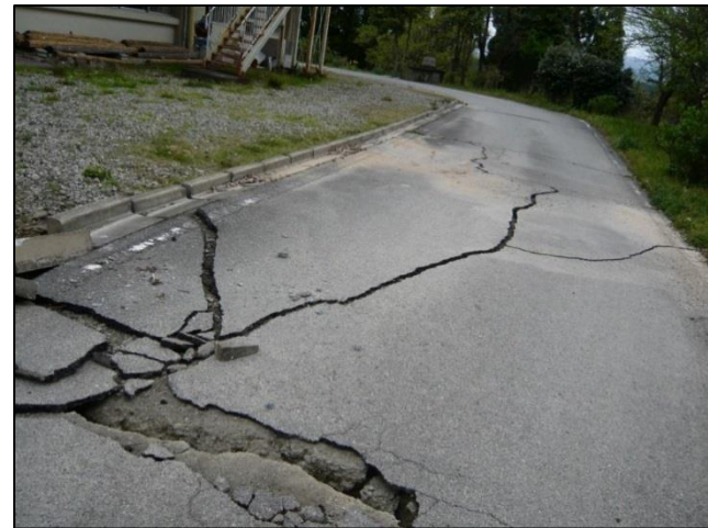
敷地内道路 地面亀裂
