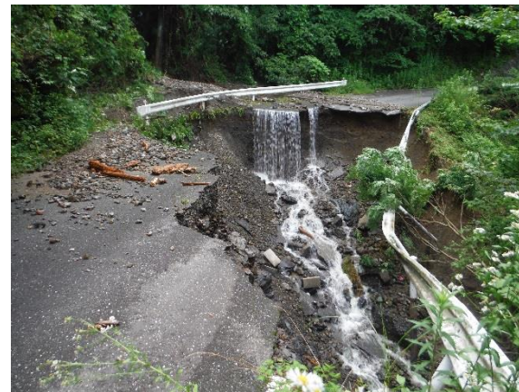
林道矢部水越線 崩落
