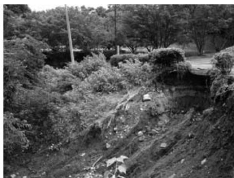
← 宇土城跡（西岡台）崩落箇所 城跡全体で計8か所が崩落。平成29年度より復旧工事を実施予定。
