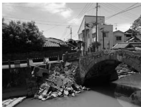
← 船場橋被災状況 欄干（手すり）の落下、石垣の崩落、アーチやその上の壁石などにずれ有り。元に戻すため、平成29年度に一度解体の後に復元を予定。
