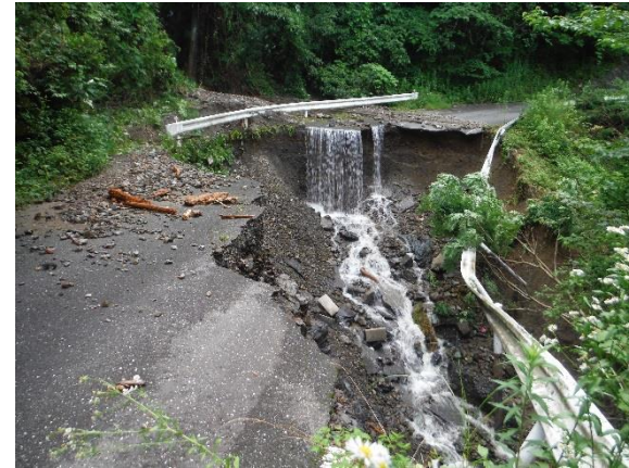
林道矢部水越線 崩落
