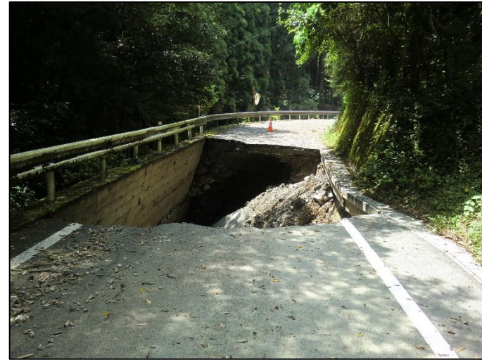
町道 藤木猿渡線（陥没により通行不可）
