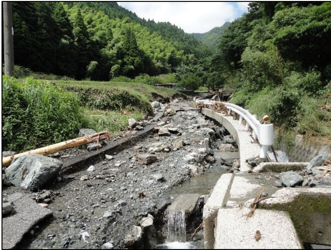
町道 岩井谷線（河川流出により通行不可）
